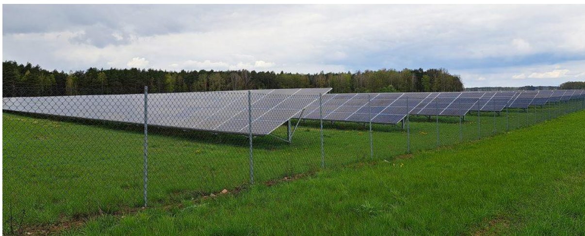
Fotografia 1. Standardowa farma fotowoltaiczna ustawiona na południe. Źródło: Fundacja PVE Dobra Energia
