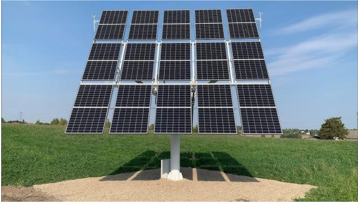
Fotografia 2. Konstrukcja obrotowa, tzw. traker solarny. Źródło: Fundacja PVE Dobra Energia
